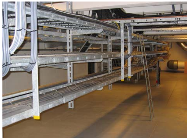
Figur 46 - Kabelrum under tavlerum
