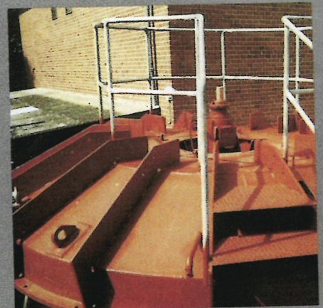
Topdæksel på vakuumtank
